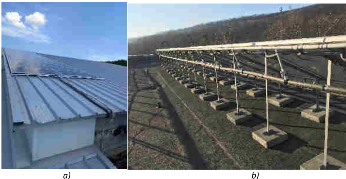
Foto 6. Exemple de utilizare a panourilor fotovoltaice termice
